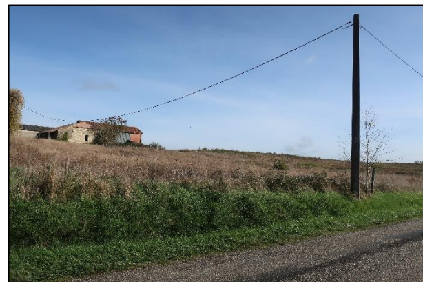
Ligne téléphonique au Sud-Ouest
